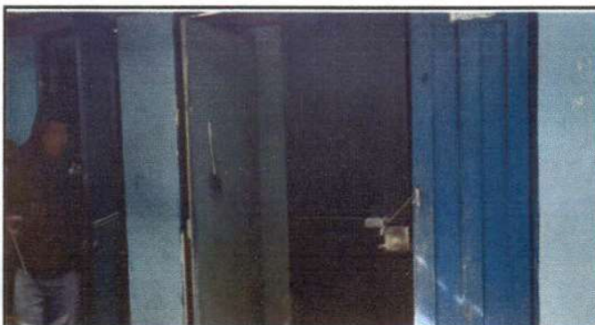
Foto 3: sustitución de puertas en mal estado por deterioro.
